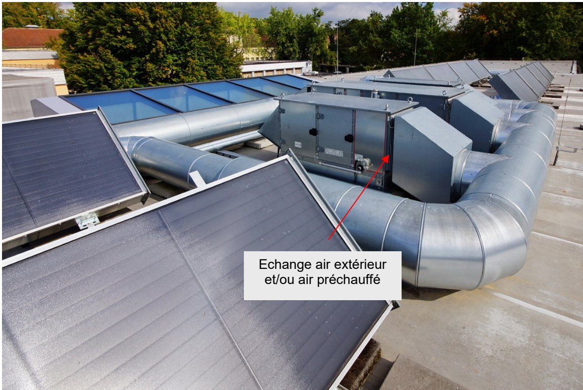
Installation JUMBOSOLAR sur CTA sans raccordement physique
