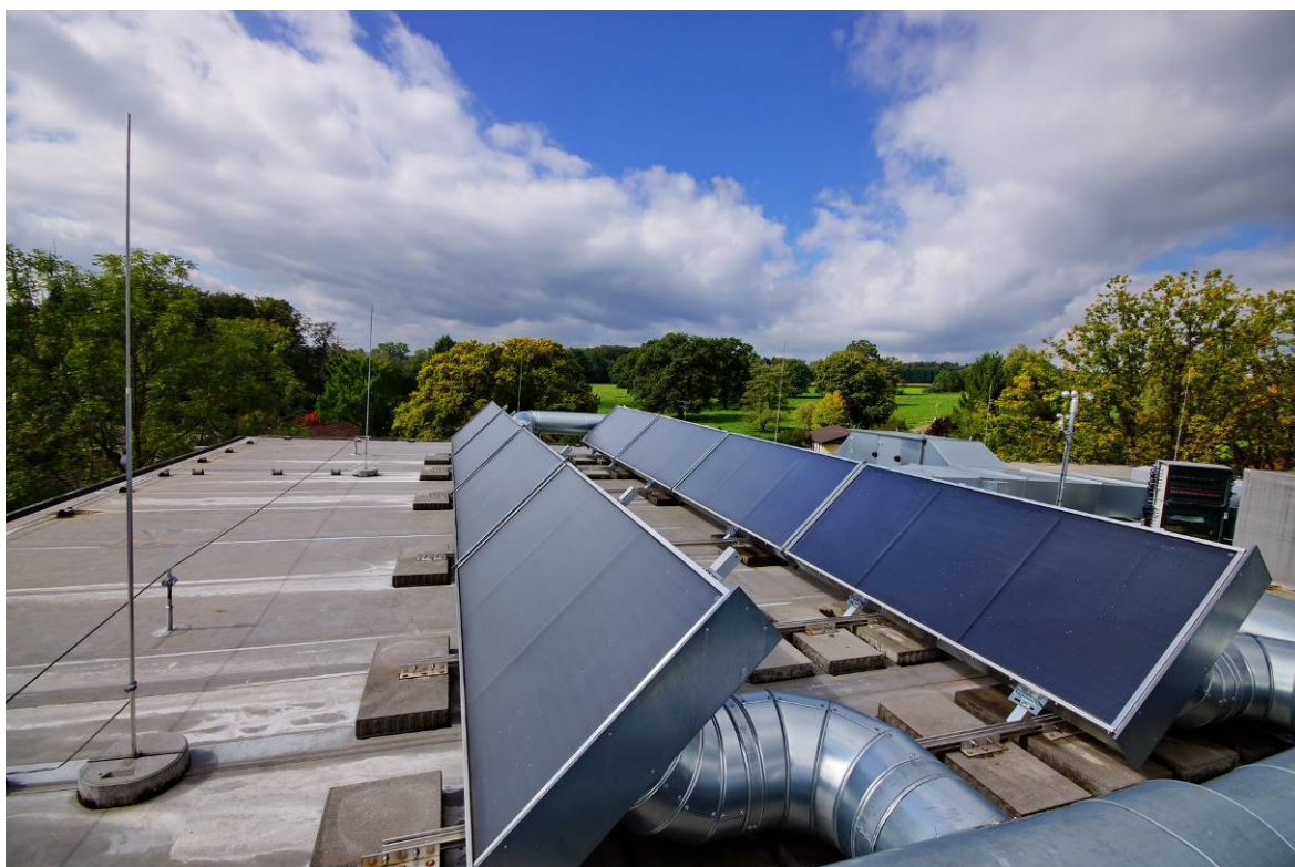
III. 46: Système AirSolaire FH-Herrsching avec installation contre le foudre
